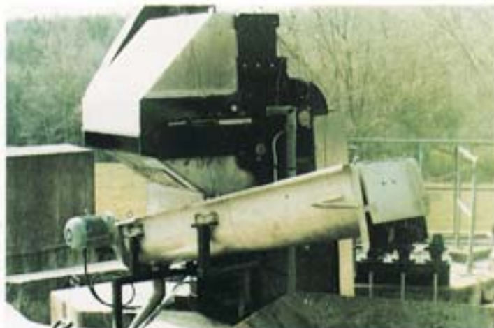
Compactador recogiendo los rechazos de un tamiz autolimpiante.
