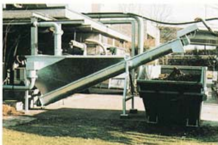
Clasificador de Arenas, a la salida de un desarenador en una planta de depuración de aguas residuales mixtas.
