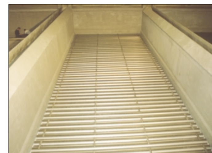
Depósito equipado con filtros Triton™
